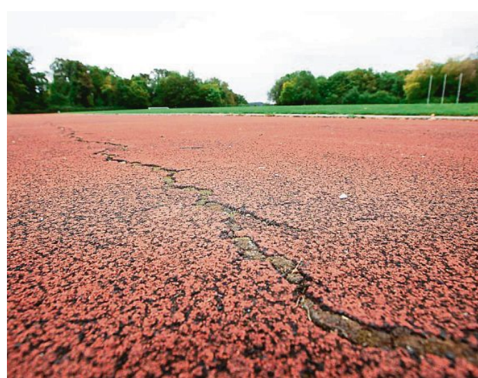
Ein Riss, soweit das Auge reicht: Die Tartanbahn im Klaus-Buchheim-Stadion soll komplett erneuert werden. FOTO: JAKSCH
